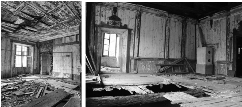
Fig. 3. Il fortissimo degrado delle stüe (locali foderati in legno) al piano primo (a sx) e al piano secondo (a dx)
