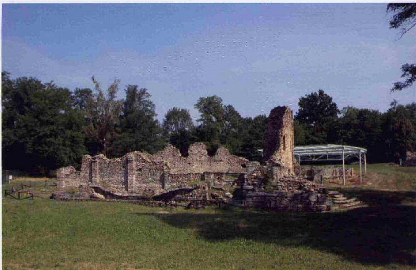
FIGURA 29 • Castelseprio, parco archeologico, Cascina Monastero di San Giovanni. La Basilica di San Giovanni al termine degli interventi conservativi: le cause di degrado sono da ricercarsi nella presenza abbondante di acqua nelle murature, per deposito nelle parti concave dei muri, nei periodici cicli di gelo e disgelo e nella crescita di estesi apparati radicali.
