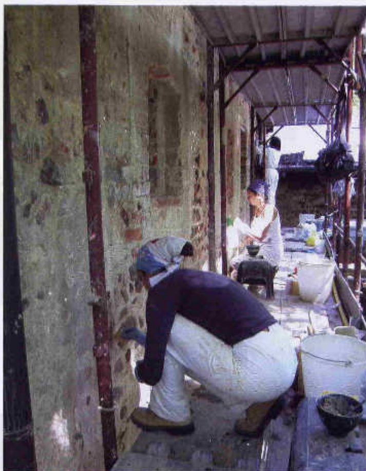
FIGURA 5 • Castelseprio, parco archeologico, Cascina Monastero di San Giovanni. Fasi dell'intervento di restauro: attacco biologico, processi disagregativi delle malte e dei laterizi, distacco e sollevamento dei lacerti di intonaco. Dopo la rimozione dei depositi superficiali incoerenti è stata effettuata una disinfezione di tutte le superfici con apposito biocida.
