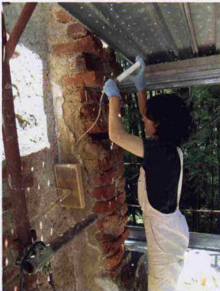
FIGURA 7 • Castelseprio, parco archeologico, Cascina Monastero di San Giovanni. Difetti di adesione e coesione nella sequenza degli intonaci. Il consolidamento in profondità è avvenuto mediante iniezioni di malta idraulica con aggiunta di un fluidificante e facendo riaderire le parti di intonaco distaccate dal supporto.
