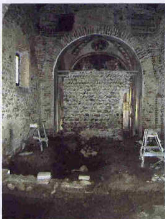
FIGURA 3 • Castelseprio, parco archeologico. Stato di fatto della chiesa: costituita da aula con copertura a doppia falda era priva di pavimentazione e articolata in due campate separate da un arco-diaframma ricostruito durante l'intervento degli anni '90; l'abside affrescata era separata dal resto dell'aula da un muro.
