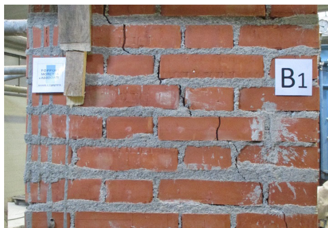
Figura 1. Fessura di taglio che coinvolge giunti di malta e mattoni
