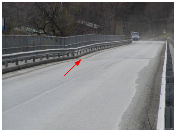
Fig. 2 - avvallamento del piano stradale
