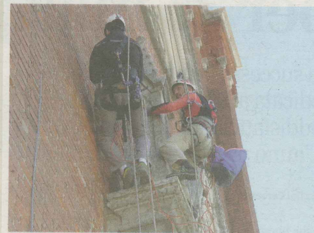
Sulla facciata sono stati applicati alcuni sensori
